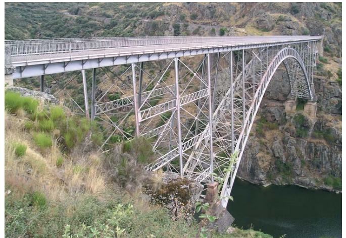
Estructura de acero del puente de Requejo en Pino del Oro (Zamora).
